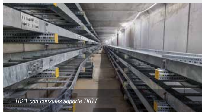
Soportes siFramo en el edificio Tokamak.
