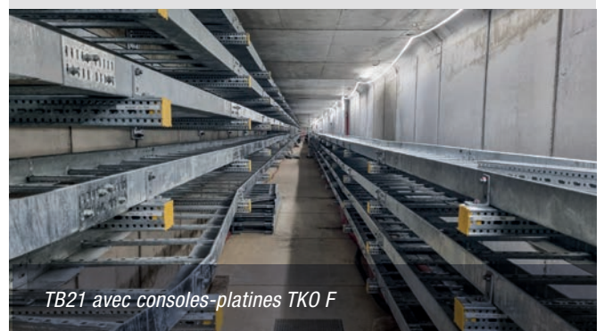
Supports siFramo dans le bâtiment Tokamak
